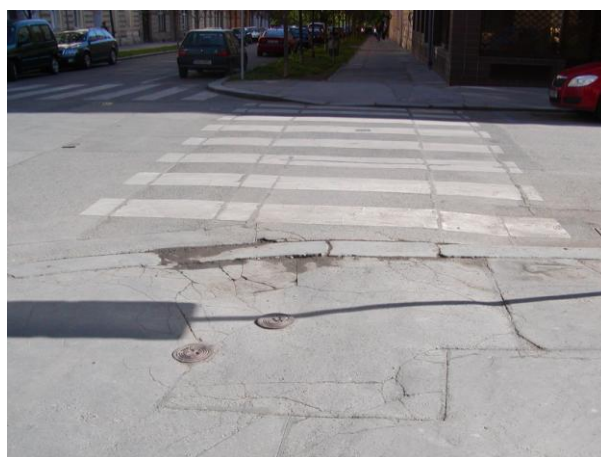
Šachty vodovodů, uliční vpusti, chybějící hmatné úpravy, špatný stavební stav chodníku
