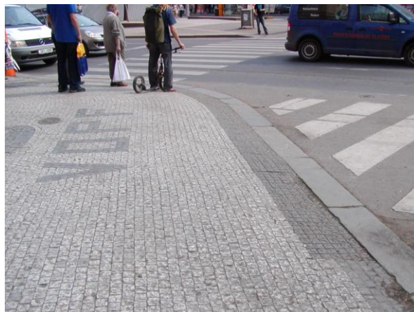
Východní nároží, chybějící signální pás
